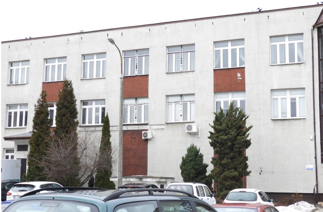
Fot. 2. Elewacja przeznaczona do termoizolacji - widok od strony wschodniej, brak szczelin dylatacyjnych. Pod krawędzią dachu widoczne otwory wentylacyjne stropodachu.
