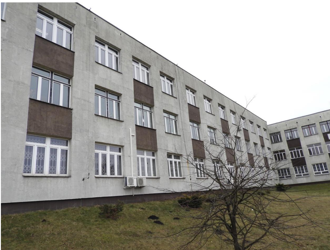
Fot. 4. Elewacja przeznaczona do termoizolacji - widok od strony zachodniej, brak szczelin dylatacyjnych. Pod krawędzią dachu widoczne otwory wentylacyjne stropodachu.
