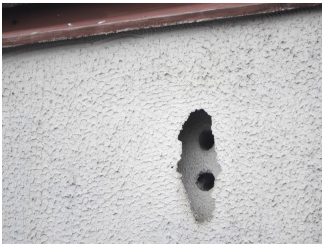
Fot. 5. Otwory wentylacyjne stropodachu, warstwa docieplenia dookoła otworu wyrwana przez kawki.
