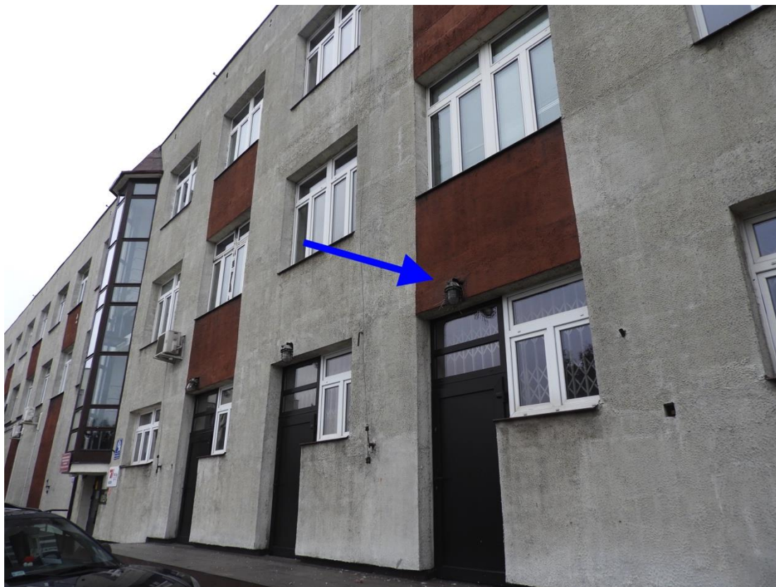
Fot. 7. Elewacja z wejściem do budynku, strzałką zaznaczono gniazdo pomiędzy lampą a dociepleniem.
