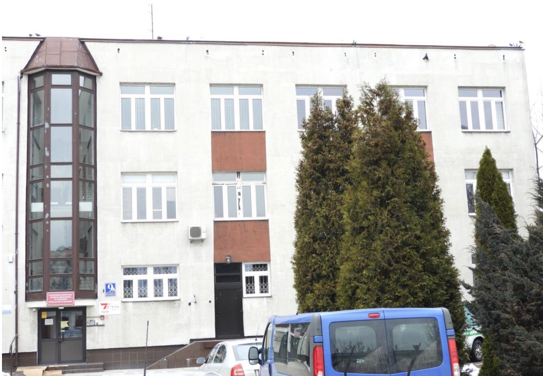
Fot. 1. Elewacja przeznaczona do termoizolacji - widok od strony wschodniej, brak szczelin dylatacyjnych. Pod krawędzią dachu widoczne otwory wentylacyjne stropodachu.
